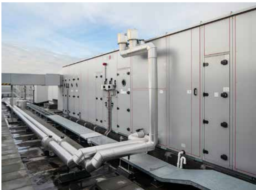
De luchtbehandelingskasten zijn 18 meter lang, ongeveer 6 meter breed en 3 meter hoog.
