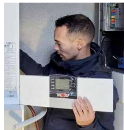
Martijn Heeringa verzorgt de inbedrijfstelling van de WOLF-installatie in de Grijs Silo.
