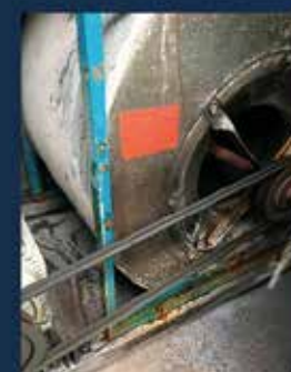
Oude situatie: Riemgedreven slakkenhuisventilator
