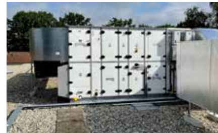
Op het dak van de uitbreiding is een WOLF CRL compactunit geplaatst.
