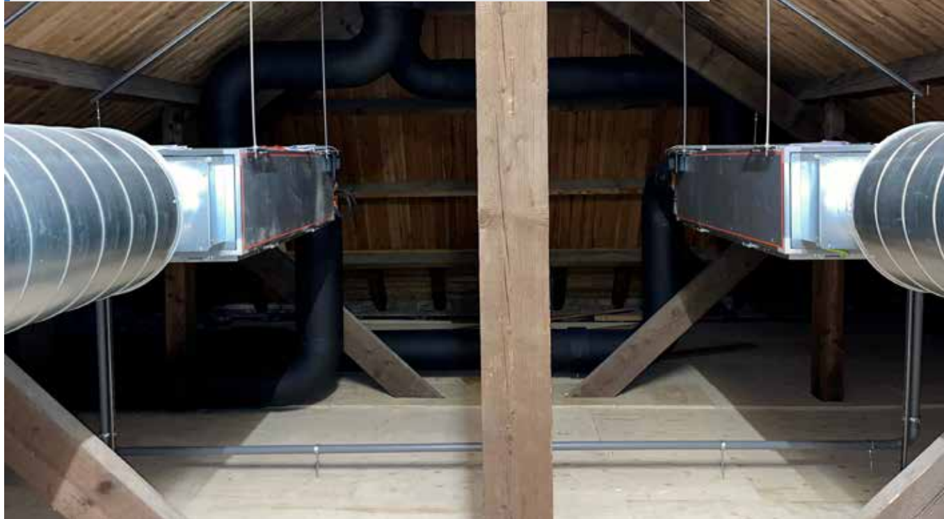
De WTW-units zijn opgehangen aan de dakspanten van de opslagzolder, zodat de serviceluiken gemakkelijk benaderd kunnen worden.
