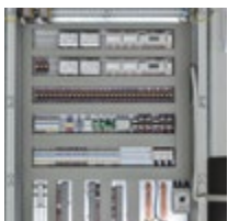
4 Komplette Verkabelung inkl. speziell auf das Gerät abgestimmtem Schaltschrank inkl. Controller
