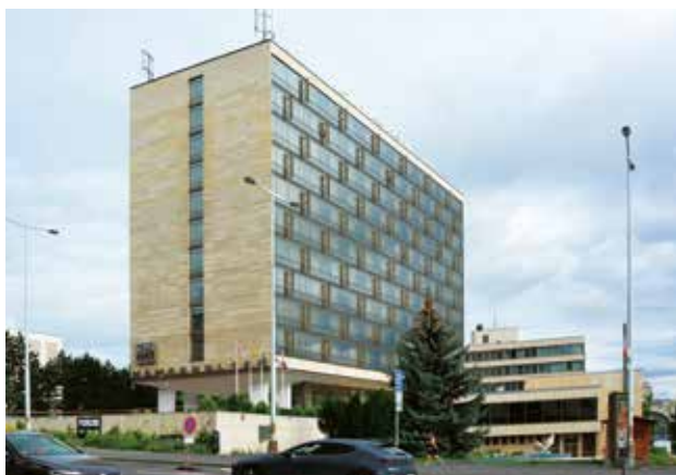
Hotel Mamashelter Praha vzduchotechnické jednotky KG Top
